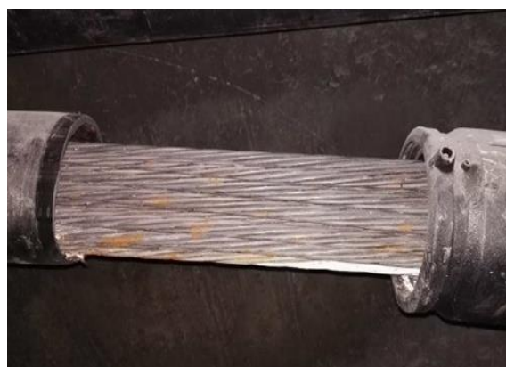
Fot. 4. Przerwana ciągłość osłony w miejscu jej łączenia na skutek zerwania kabla
