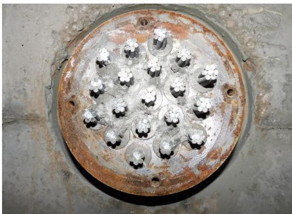
Fot. 3. Obraz powierzchniowej korozji zakotwienia na powierzchni styku z jego osłoną (widok po zdemontowaniu osłony i skuciu zaczynu cementowego)
