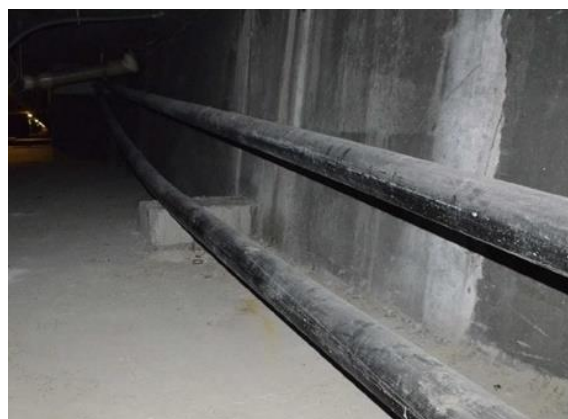
Fot. 6. Widoczny zwis nienaprężonego kabla (dolnego) w miejscu oddalonym od miejsca zerwania
