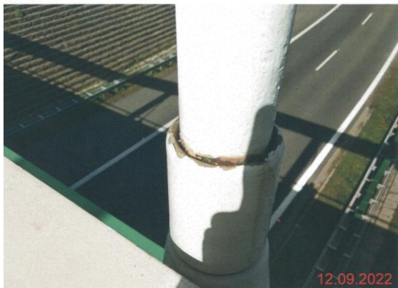
Fot. 1. Korozja cięgna wynikająca z działania czynników atmosferycznych
