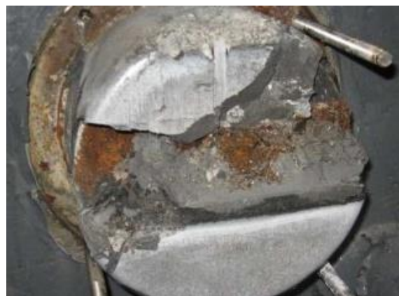
Fot. 6. Zaawansowana korozja zakotwienia i stali sprężającej na skutek wadliwego wykonania zabezpieczenia antykorozyjnego iniekcją cementową (widok po zdjęciu osłony zakotwienia)
