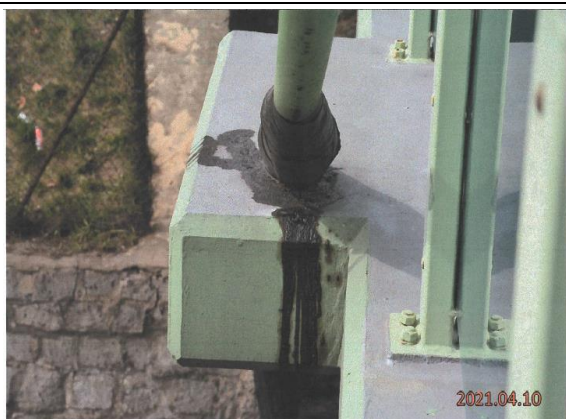
Fot. 7 Wyciek medium konserwującego w strefie zakotwienia
