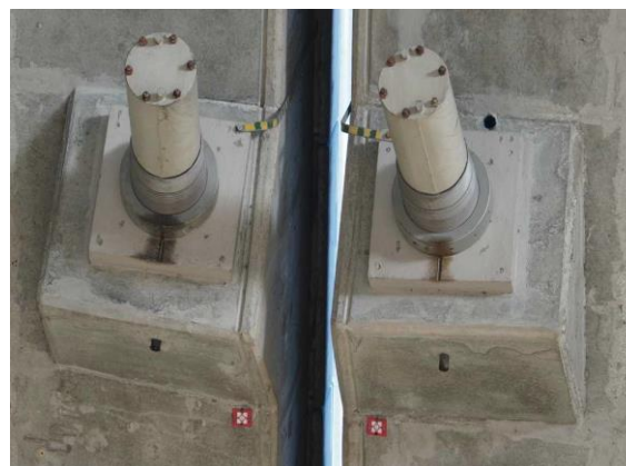
Fot. 6. Wycieki smarów zabezpieczających z zakotwienia cięgien
