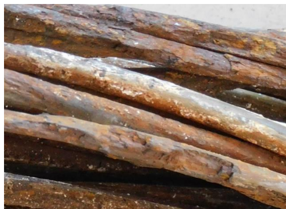
Fot. 6. Szczegół z obrazem ubytków korozyjnych w drutach lin sprężających
