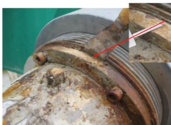
Fot. 3. Skorodowana i nieuszczelna osłona zakotwienia.
