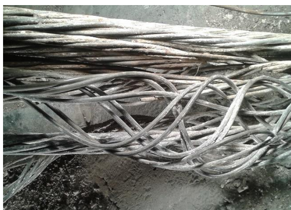
Fot. 3. Obraz w miejscu zerwania kabla po usunięciu osłony i iniektu (nie wszystkie liny uległy zerwaniu w tym samym przekroju)
