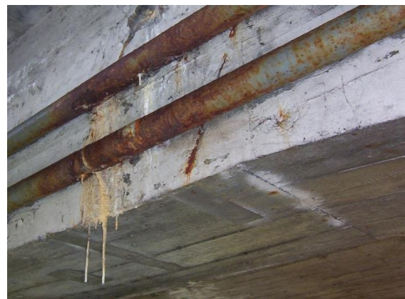
Fot. 4. Zniszczone powłoki malarskie i korozja stalowej rury osłonowej zewnętrznych kabli wzmacniających
