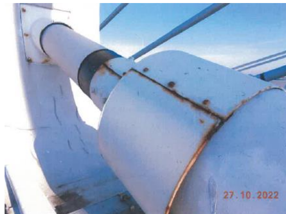
Fot. 2. Skorodowana osłona zakotwienia. Korozja dotyczy najkrótszego kabla mostu extradosed.
