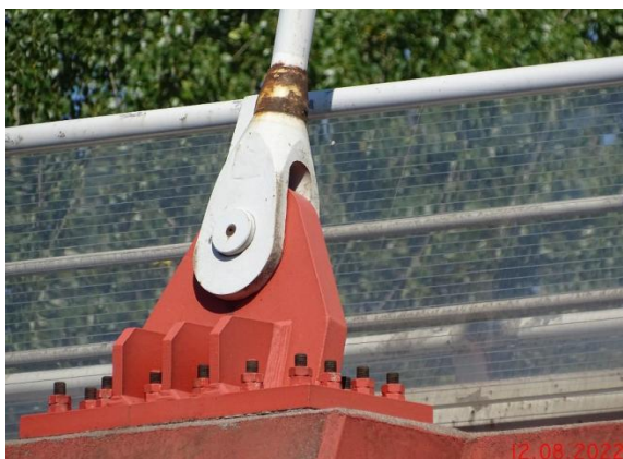
Fot.10. Korozja ciężna prętowego w strefie zakotwienia
