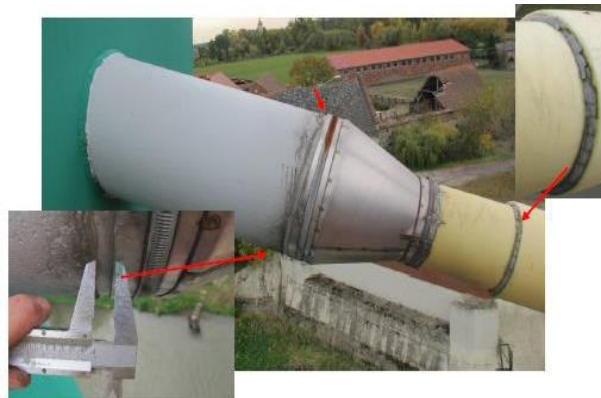
Fot 10. Widoczne przemieszczenie, zsunięcie się kołnierza osłaniającego (o 10 mm), zniszczone uszczelnienia kołnierza
