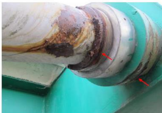
Fot. 5. Korozja osłony zakotwień kabli sprężających i połączenia
