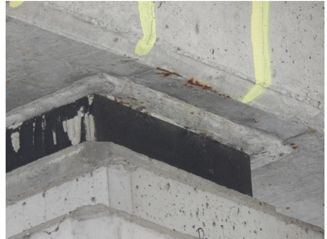
Zarysowania dźwigarów głównych zaobserwowane bezpośrednio nad podporą pośrednią
