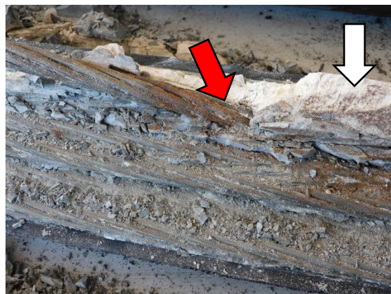
Fot. 4. Korozja lin kabla w którym górna część przekroju rury osłonowej była wypełniona iniektem o niewłaściwej jakości (widok po usunięciu fragmentu rury osłonowej)
