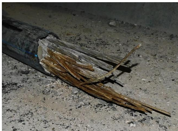
Fot. 1. Obraz jednego z końców kabla w miejscu jego zerwania (zerwania wszystkich lin w jednym przekroju kabla)
