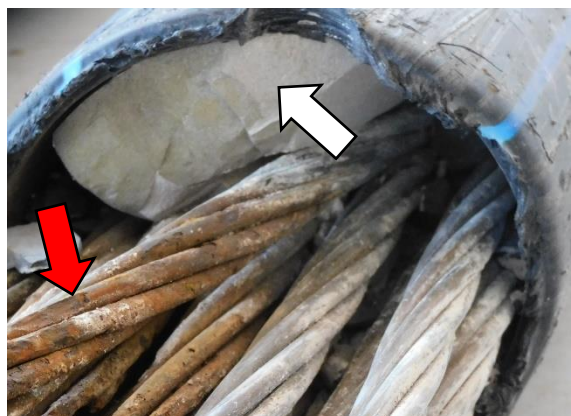
Fot. 5. Ubytki korozyjne stali sprężającej, w miejscu gdzie w części przekroju rury osłonowej występował iniekt o niewłaściwej jakości (widok po usunięciu fragmentu rury osłonowej)
