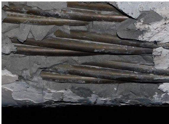
Fot. 1. Obraz pozbawionej korozji powierzchni lin sprężających kabla w miejscu prawidłowo działającego zabezpieczenia antykorozyjnego (widok tuż po usunięciu fragmentu zaczynu iniekcyjnego kabla)
