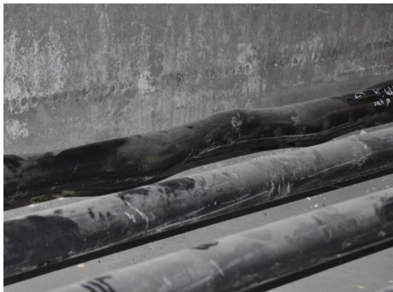
Fot. 1. Deformacje rury osłonowej kabla spowodowane gwałtownym zwolnieniem naciągu w pojedynczych linach w trakcie sprężania lub zerwaniem kabla
