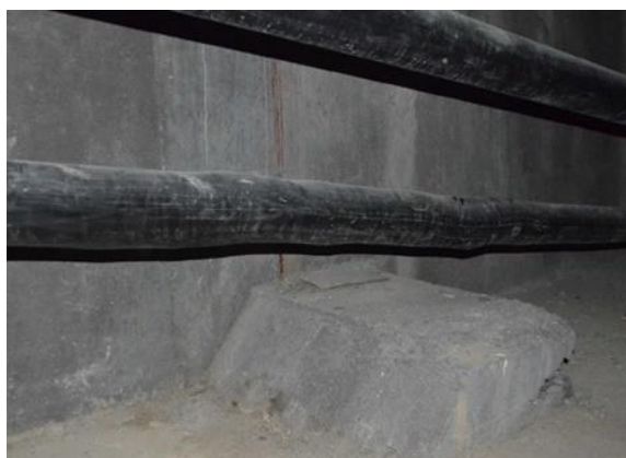
Fot. 5. Widoczne deformacje osłony spowodowane zerwaniem kabla
