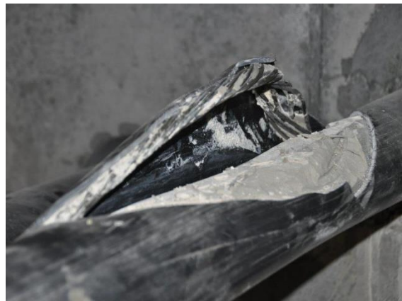
Fot. 2. Rozerwanie rury osłonowej na skutek gwałtownego zwolnienia siły w pojedynczej linie w czasie sprężania
