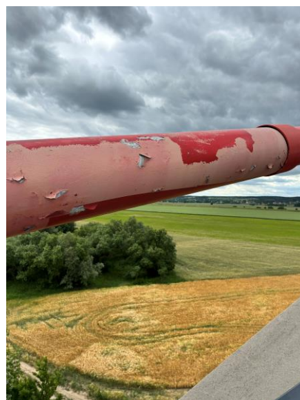
Fot 14. Ubytki, delaminacja powłok antykorozyjnych
