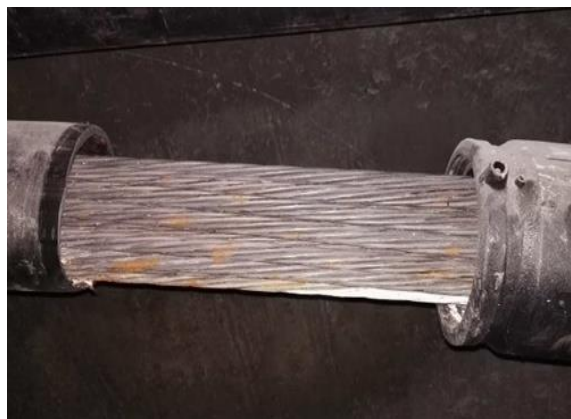
Fot. 3. Przerwana ciągłość osłony w miejscu jej łączenia na skutek zerwania kabla
