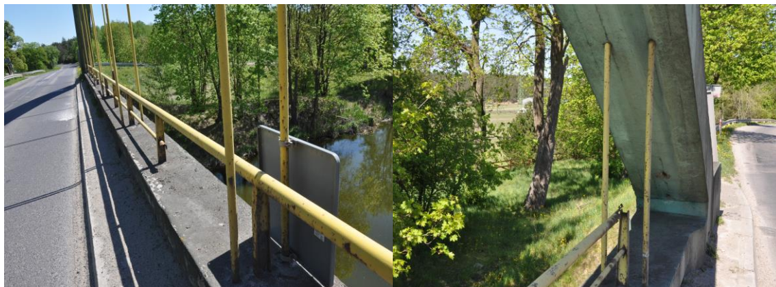
Fot. 7. Punktowe ogniska korozji wieszaków
