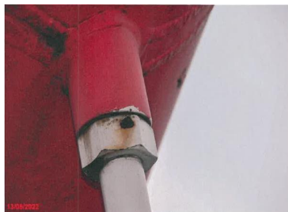
Fot. 4. Korozja konstrukcji stalowej wieszaka kładki dla pieszych
