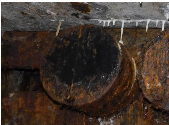
Fot. 5. Obraz korozji ogólnej stalowej osłony i bloku zakotwienia z widocznymi ubytkami materiału
