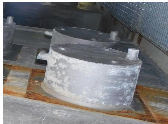
Fot. 4. Obraz powierzchniowej korozji płyty oporowej zakotwienia
