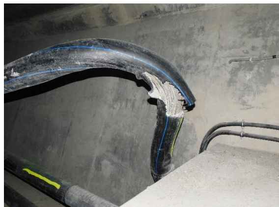
Fot. 2. Obraz deformacji zerwanego kabla w miejscu jego przejścia przez dewiator
