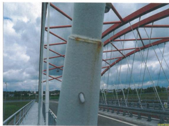
Fot. 2. Miejscowe zacieki korozyjne świadczące o uszkodzeniu powłoki ochronnej stalowego cięgna, spowodowane starzeniem się zabezpieczenia antykorozyjnego
