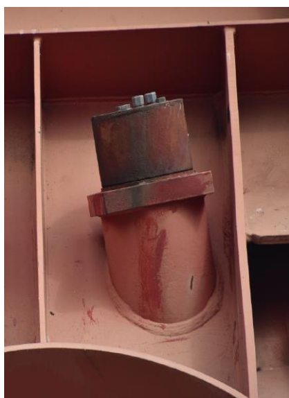
Fot. 9 Korozja i zniszczone zabezpieczenie antykorozyjne zakotwienia
