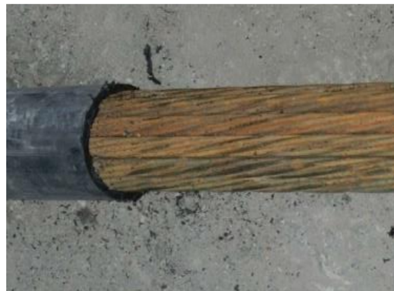
Fot. 2. Korozja powierzchniowa lin kabla w którym w ogóle nie wykonano zabezpieczenia antykorozyjnego (widok po usunięciu fragmentu rury osłonowej)
