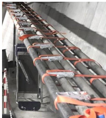
Fot. 7. Przykład zabezpieczenia kabli pasami transportowymi
