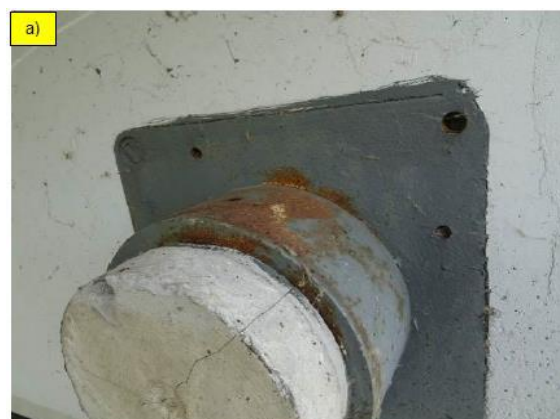
Fot. 4. Korozja płyty kotwiącej kabli sprężających (rysa na betonie zabezpieczenia ocena w tablicy 5.1.6.)
