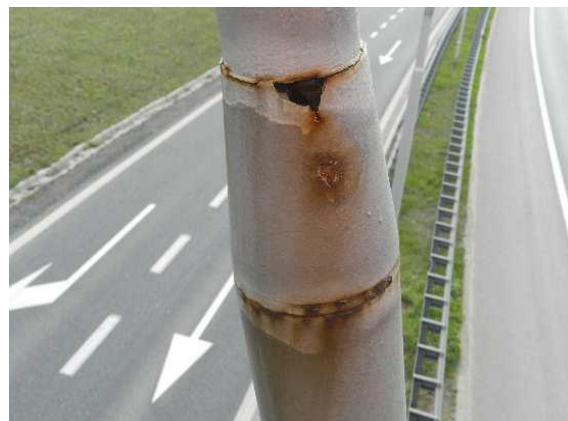
Fot. 2. Pęknięcie i deformacja osłony kabla, rdzawy wyciek
