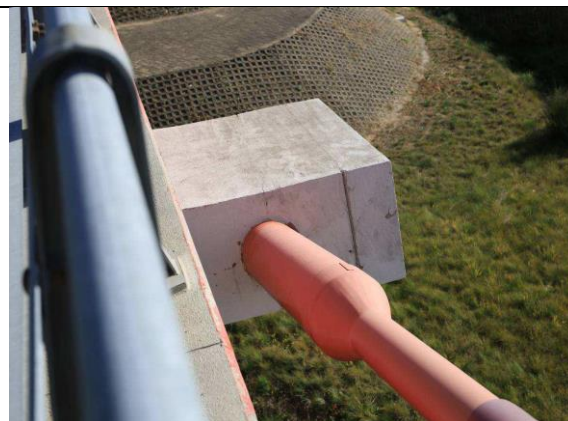
Fot. 8. Zarysowania krzyżowe wsporników na wlocie rury obsadowej wanty
