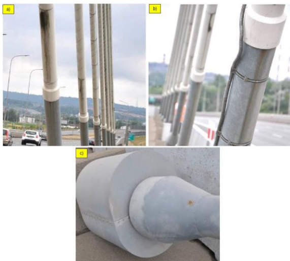
Fot. 1. Niewielkie zabrudzenia rur osłonowych want oraz zacieki na rurach antywandalistycznych, występujące z różną intensywnością w kilkunastu wantach (fot. a, b). Niewielkie ognisko korozji na rurze antywandalistycznej wanty (fot. c)
