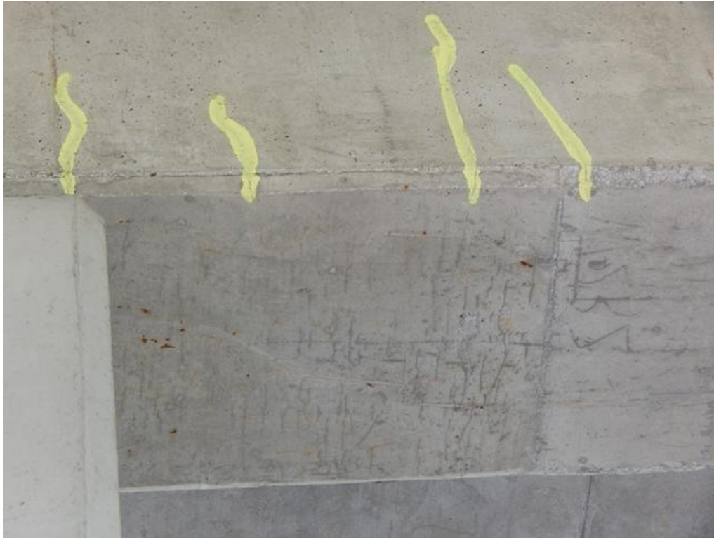
Zarysowania dźwigarów głównych zaobserwowane w pobliżu podpory pośredniej
