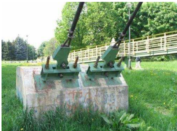
Fot. 1. Efekty korozji śrub zakotwienia w betonie.
