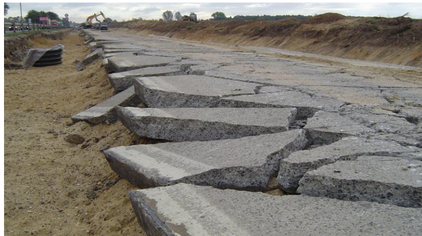
Odprężone płyty na A18
