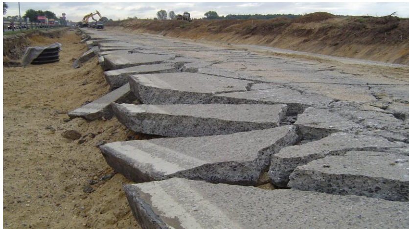
Odprężone płyty na A18
