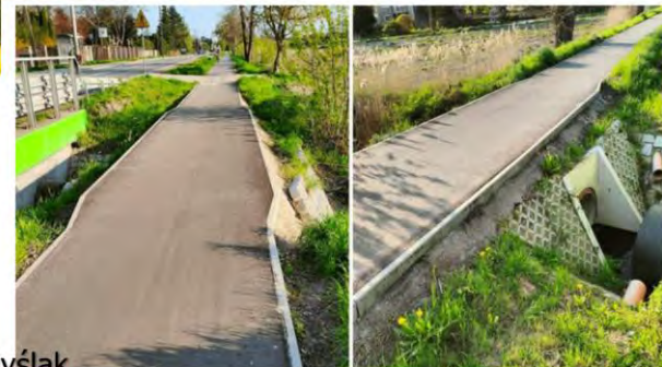
Fot. nr 4.2.2.25 Niebezpieczny odcinek drogi rowerowej nad przepustem
