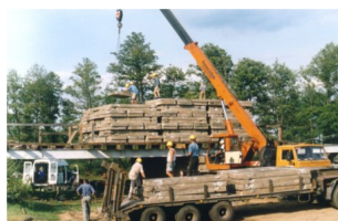
Fot. 11. Próba wytrzymałości wiaduktu przeprowadzona przy użyciu znormalizowanych samochodów ciężarowych (wiadukt nad ul. Obozową w ciągu Al. Prymasa Tysiąclecia w Warszawie – październik 2000 r).
